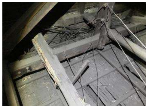
圖 2-51 事務室屋架多處有嚴重蛀蝕情形
